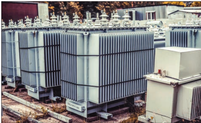
34-сурет. Күш трансформаторы, ҚР, Кентау қаласы
